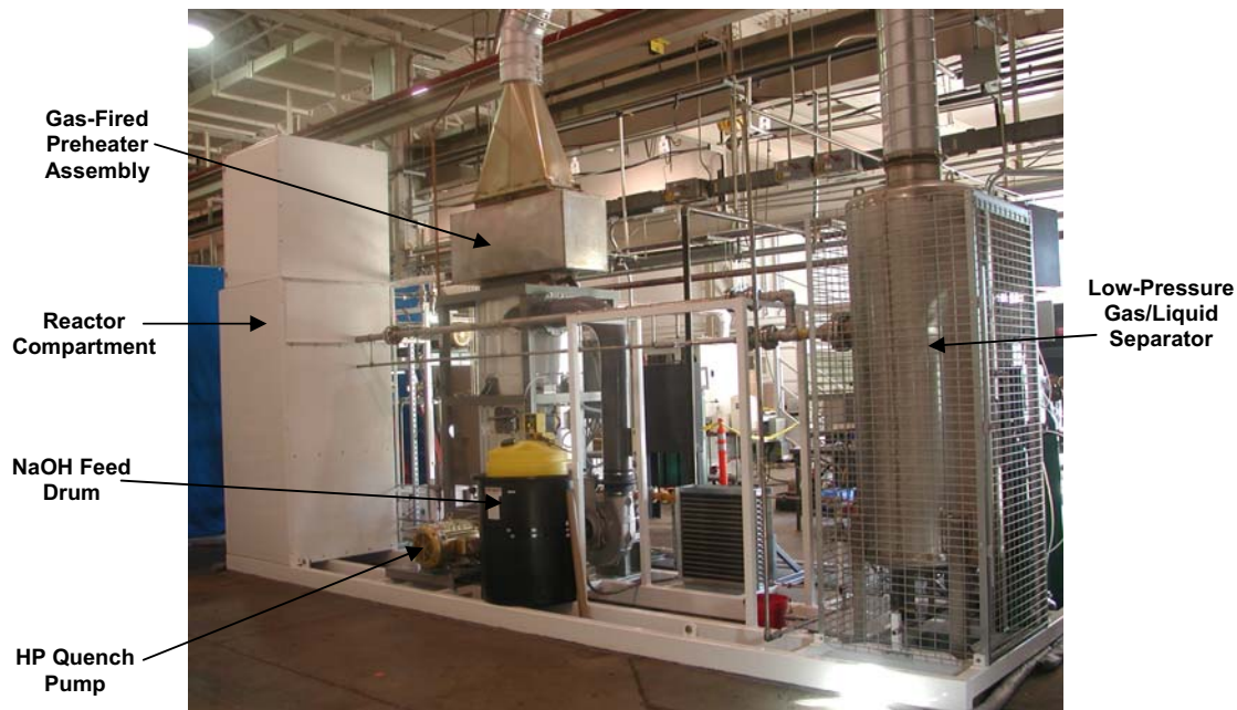
Fig. 4 – GA iSCWO Skid
